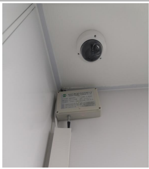
直线加速器室辐射监测仪、监控
