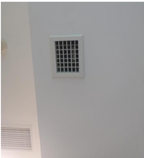
机械排风装置
